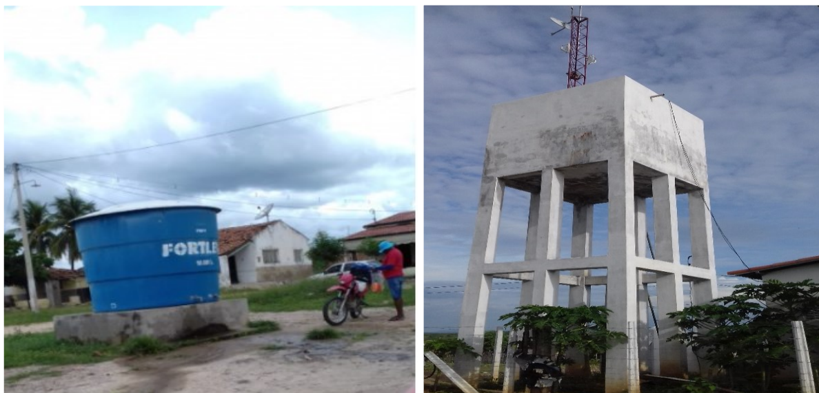
Figura 4 e 5 - Caixas de Água localizadas no Perímetro Irrigado e na área de atuação da Associação dos Produtores Rurais de Cacimbas e Batalhão.
